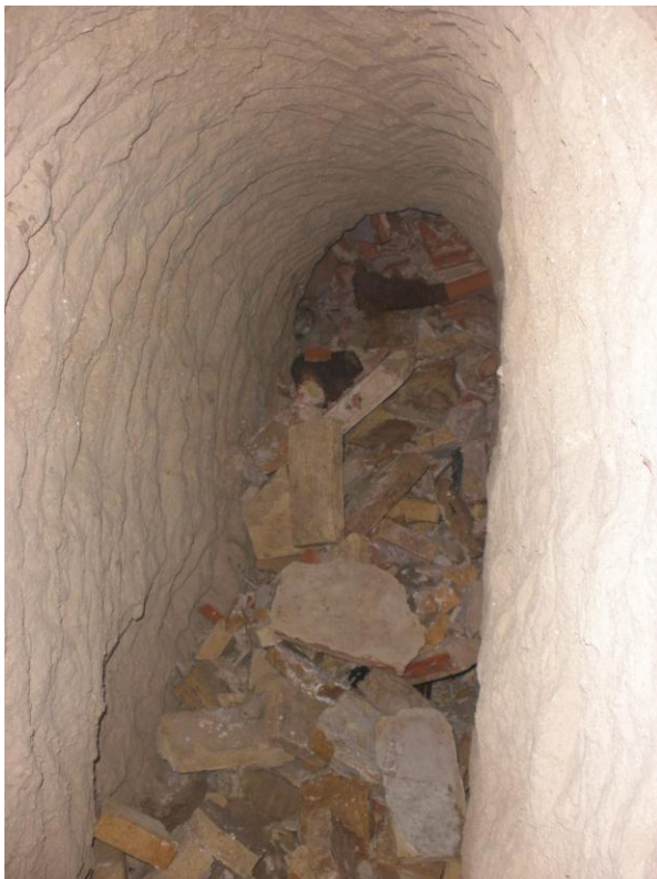
Imatge 7: Aspecte d'un aljub amb enderrocs
