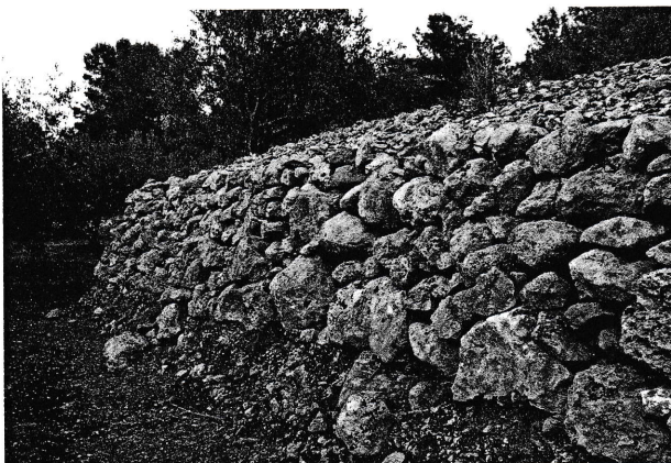
13. Calçada de marge amb pedres irregulars. (Canals, el Racó, a la vora del barranc de la Cova Hedra).
